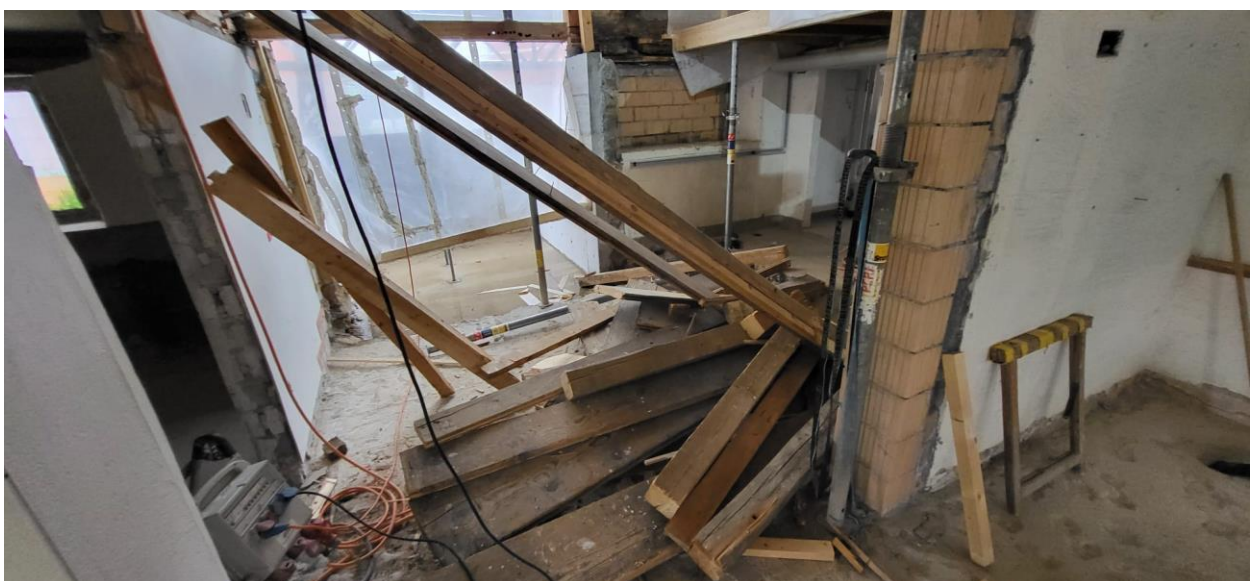
Alter, rausgerissener Boden
